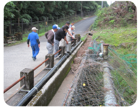
落葉による側溝の詰り
